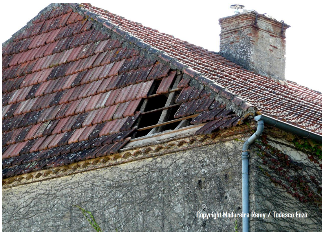
Fig. 10 – Tuiles exposées emportées
