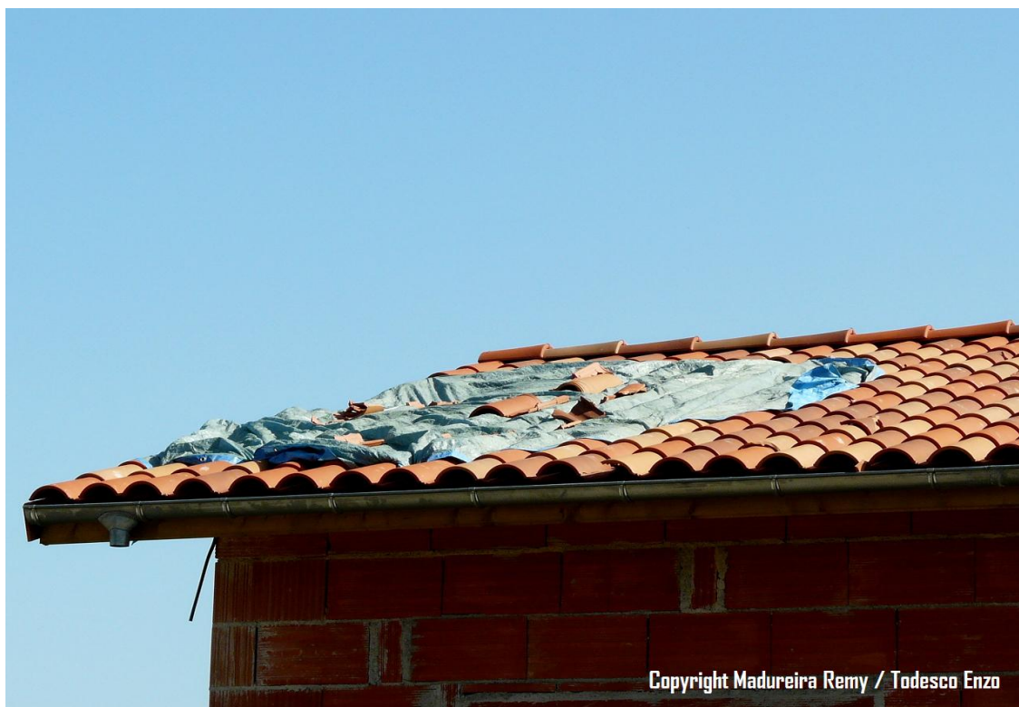
Fig. 11 – Toiture fortement endommagée
