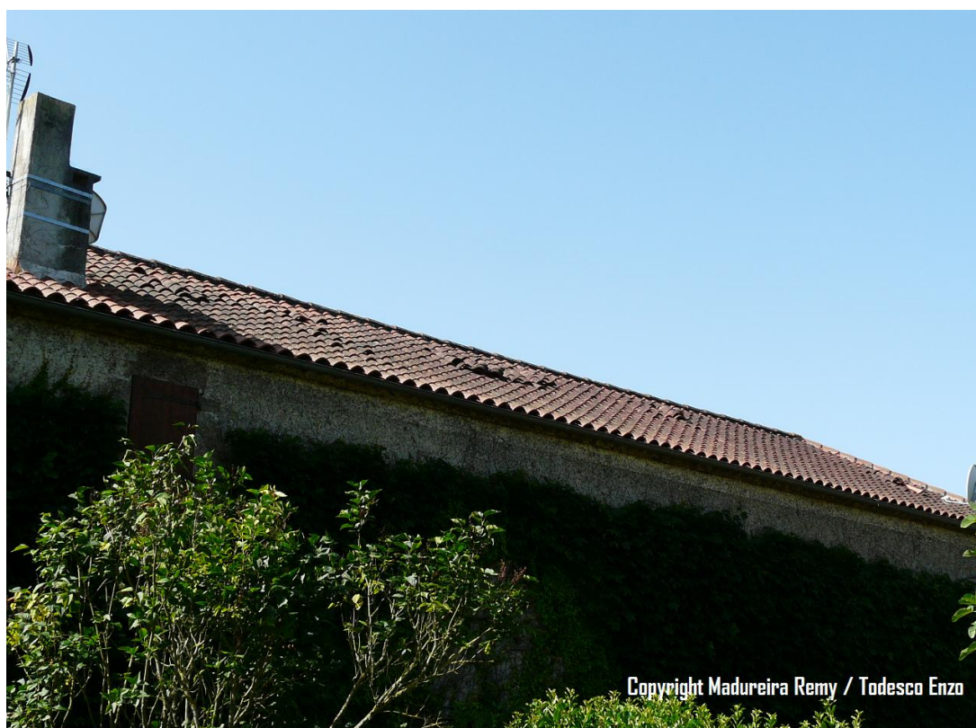
Fig. 9 – Tuiles soulevées sur la face Nord du toit
