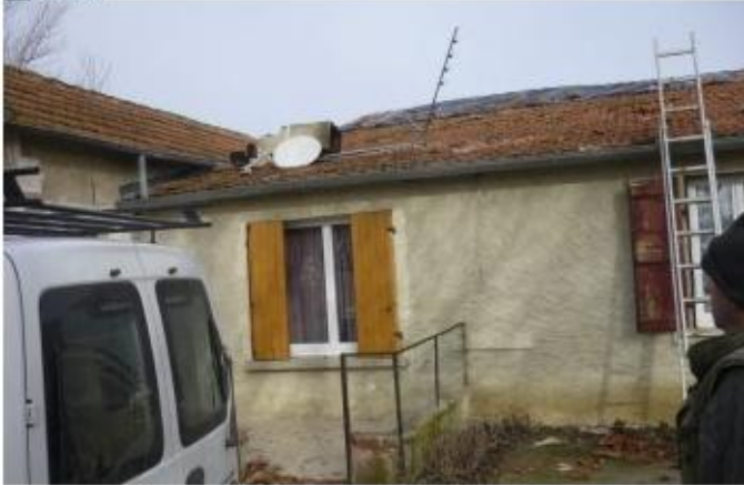
La toiture et la cheminée endommagées. Photo DDM, F. F.
