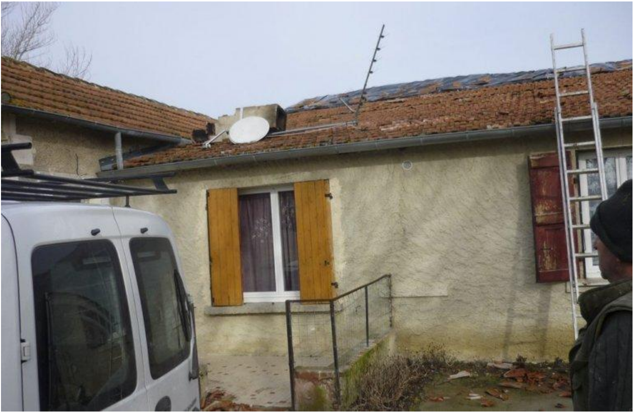
Fig. 4 – Dommages constatés sur la toiture, tuiles envolées au sol.
